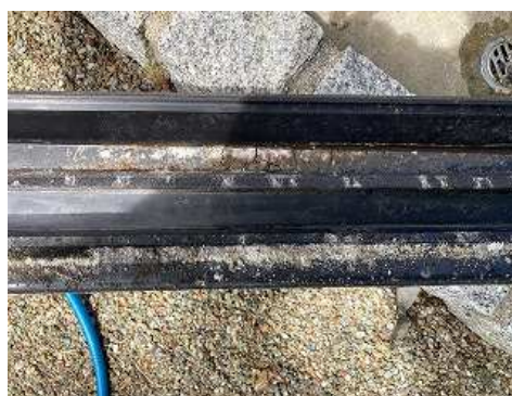
↑ドレンパンのカビと汚れ 3年位使用
