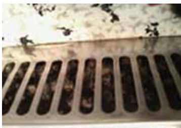
吸込み口内にも汚れが付着します。
