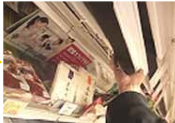
汚れている場合、 外しての清掃(洗浄)が必要です。
