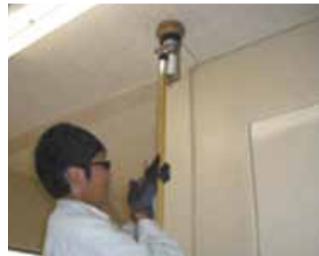
自動火災報知設備 煙感知器作動点検
