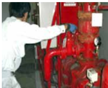
屋内消火栓設備 ポンプ点検
