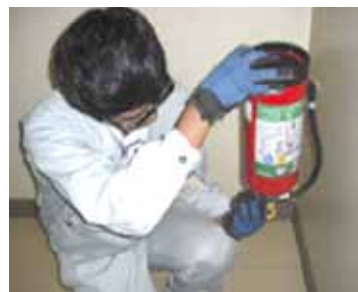
消火器具 点検
